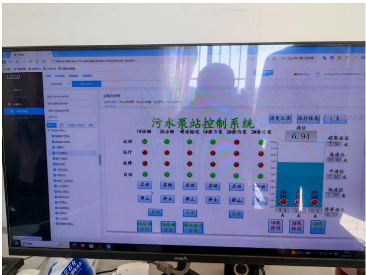
图 15 产业园泵站 2 台污水泵故障停止运行
