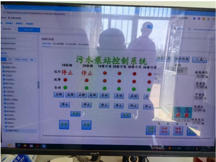
图 14 海湾路 3#泵站 2 台污水泵故障停止运行
